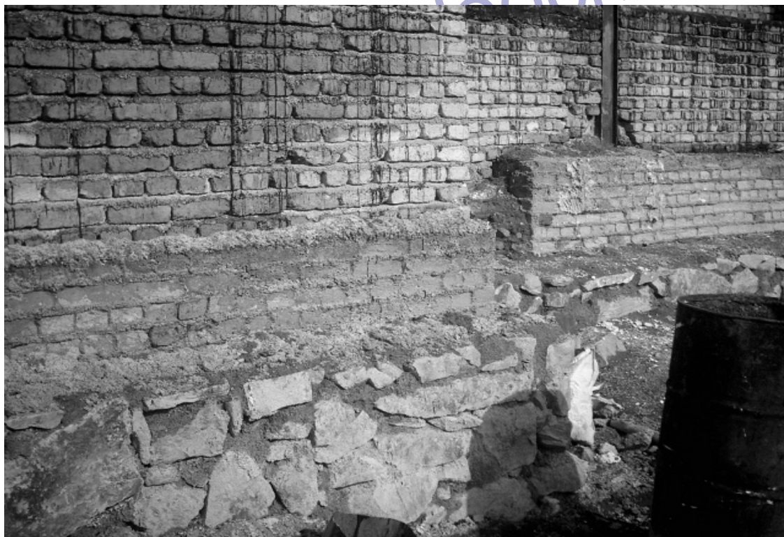
سنگ چینی زیر ساختمان به علت کم بودن مقاومت زیر پی و ناهمواری محل
